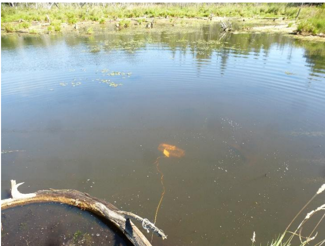
Bourolle installée dans un ancien étang de castor sous la ligne de transmission d'énergie
